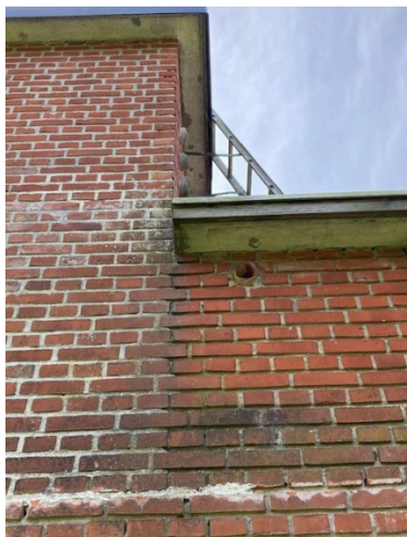
Billede af udluftningskanal der mangler insektnet.
