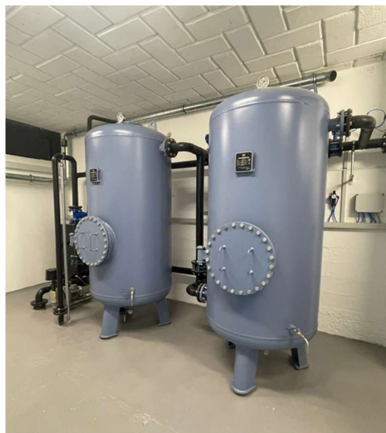
Filteranlæg for- og efterfilter
